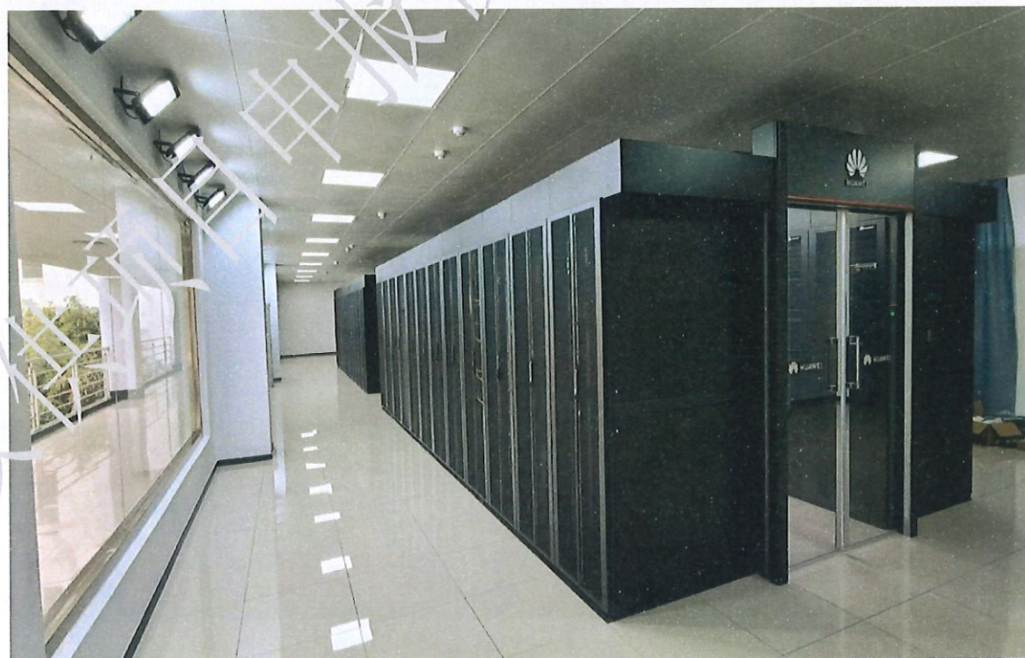
模块化机房实拍
